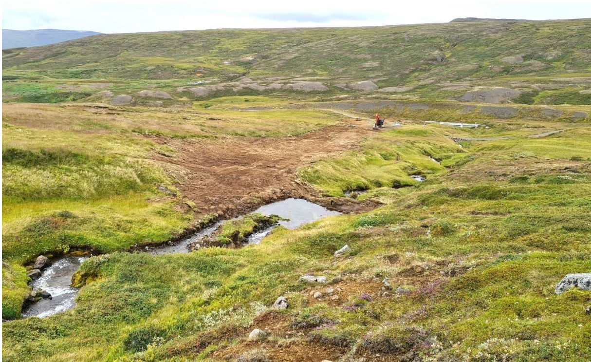
MYND 2.8 Hliðarinntak Glerárvirkjunar í Fosslæg skömmu eftir að framkvæmdum lauk. Hér sést umfang rasks og frágangur vel.
